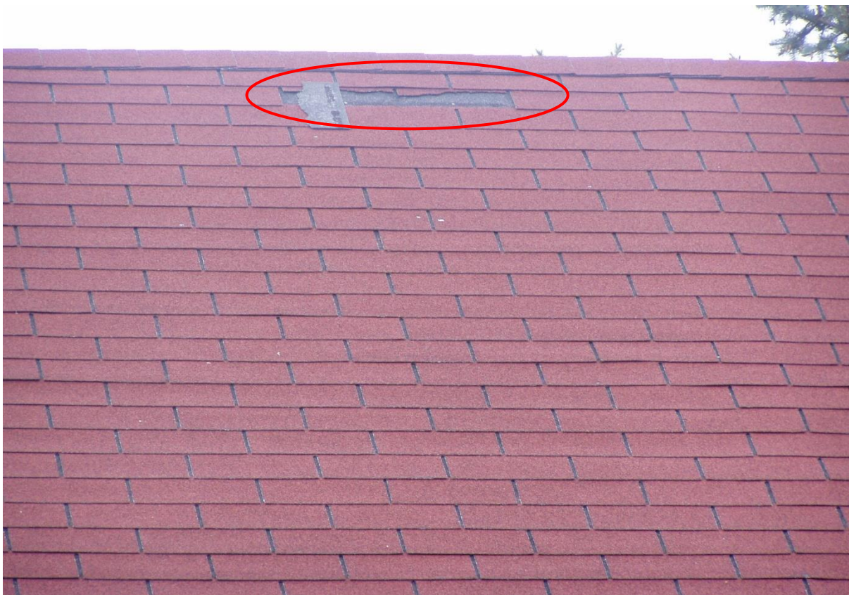
Poškozené místo (na celé střeše jsou tři místa obdobného poškození)
